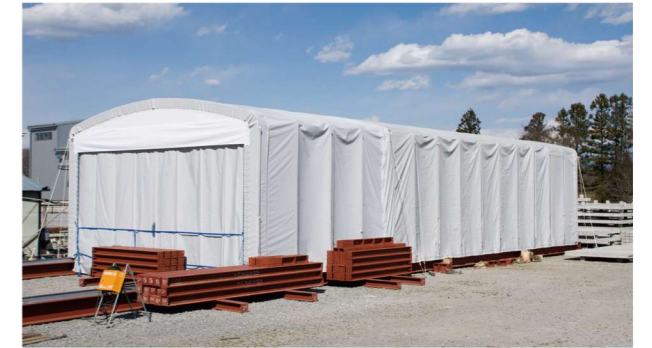
W8.5m×L:21m×H:4m 伸縮式テントハウス
